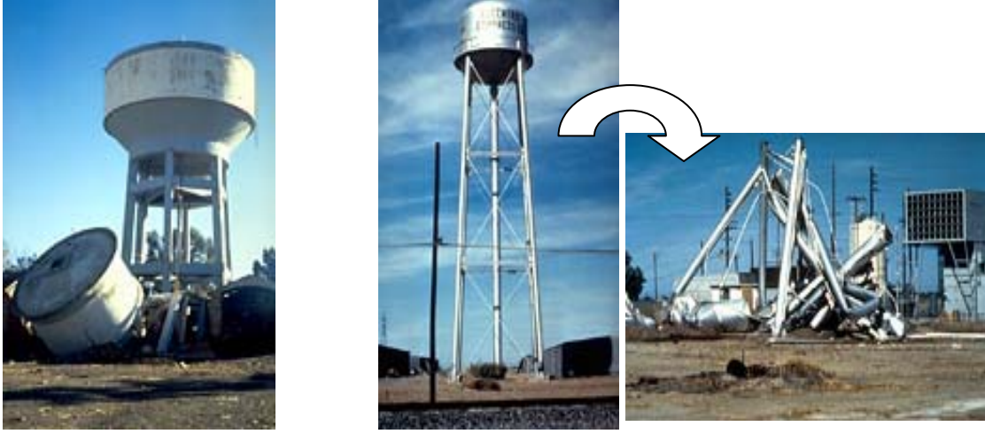
Şekil 1. Depremlerde yıkılmış betonarme ve çelik ayaklı depo görünümleri
